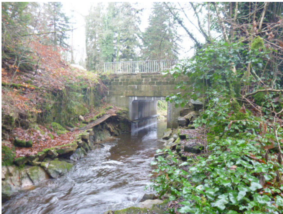
Figure 5 : Vue aval du pont cadre le 17/12/2014, implanté au droit de l'ancien déversoir (©OFB)
