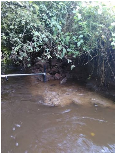
Figure 15 : Effondrement ponctuel par sapement de berges (S. Cailliez, Aout 2021)
