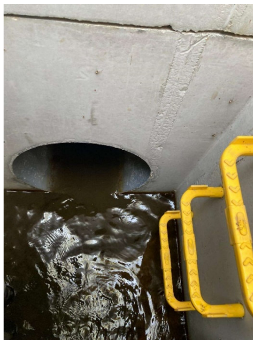
Figure 3 : Buse de restitution des eaux en aval du moine (© HUBERT & LE BIHAN, OFB, 2024 ; Forêt de Lanouée, 56).
