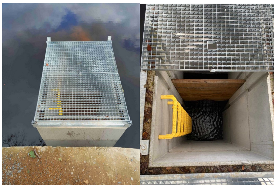
Figure 7 : a) vue du dessus d'un moine hydraulique ; b) vue de l'intérieur du moine (© HUBERT & LE BIHAN, OFB, 2024 ; Forêt de Lanouée, 56).
