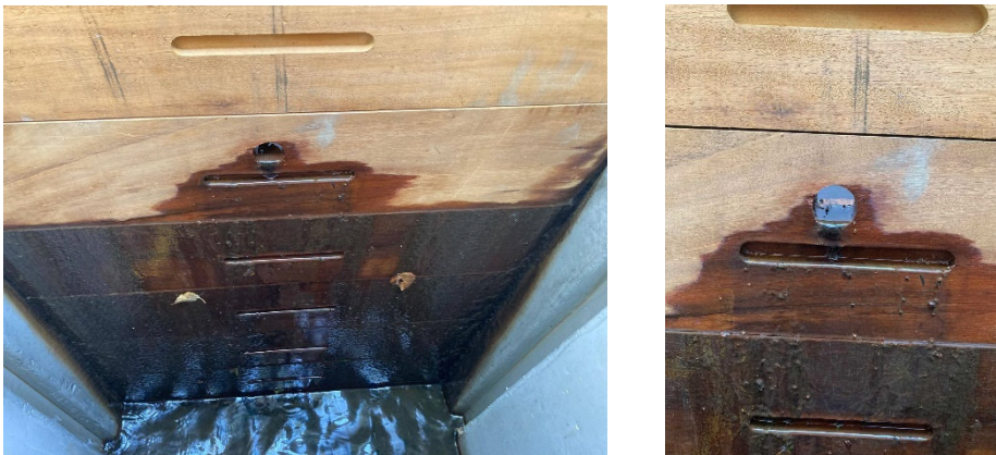
Figure 8 : Vue d'un orifice circulaire au sein d'un moine de plan d'eau, en cours de remplissage (© Hubert, OFB ; Forêt de Lanouée, 56).
