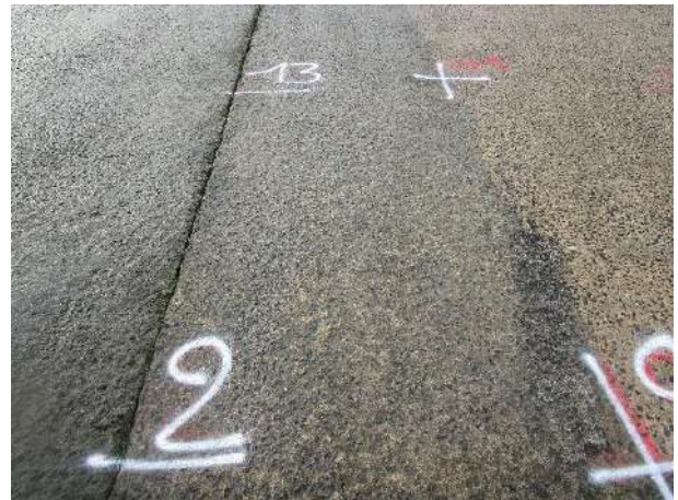
Photo n°9 : Rénoface le 10/11/2021 5 jours après traitement.
