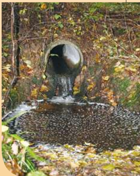
Buse ronde avec chute d'eau de 60 cm à l'aval infranchissable pour la faune aquatique.
