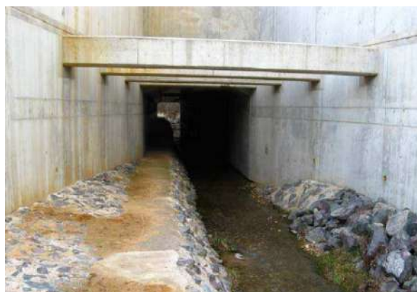
Vue à l'intérieur de l'ouvrage : fil d'eau reconstitué, banquettes petite faune, luminosité préservée.
